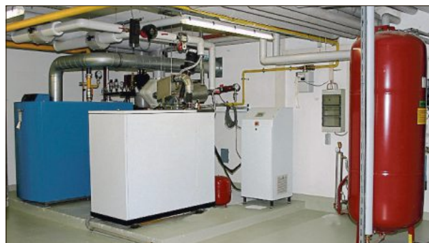
Kernstück des hochmodernen Heizungssystems ist das weiße Blockheizkraftwerk (linkes Bild) – dahinter die Gastherme für die Spitzenlastabdeckung. – Auf dem rechten Bild zeigt Hausmeister Leo Reiner (rechts) Hans Hornberger und Fachplaner Otto Huml (von links), wie er die Heizung vom Computer aus steuert. (Fotos: xk)
